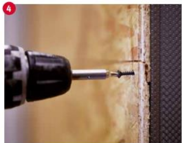
4 Befestigung der horizontalen Stöße im Ständer mit einer Schraube. Der Befestigungsabstand am Plattenrand beträgt 150 mm, in Plattenmitte 300 mm..
