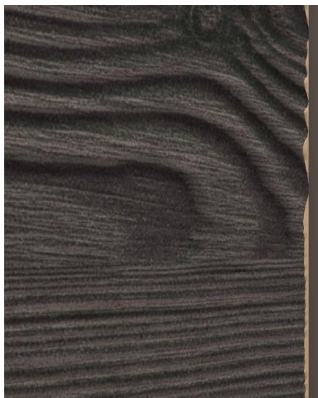
Obrázek 6 – Poškozená povrchová vrstva
