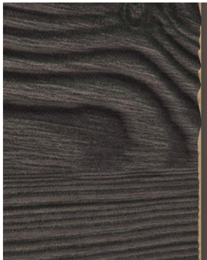
Рис. 6 – Поврежденный покровный слой
