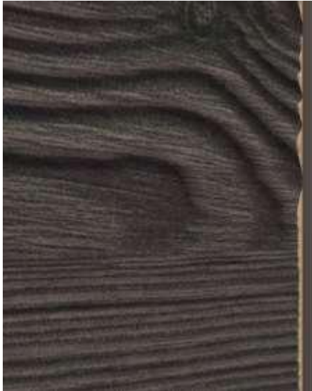
Fig. 6 – Capa de superfície dançada –
