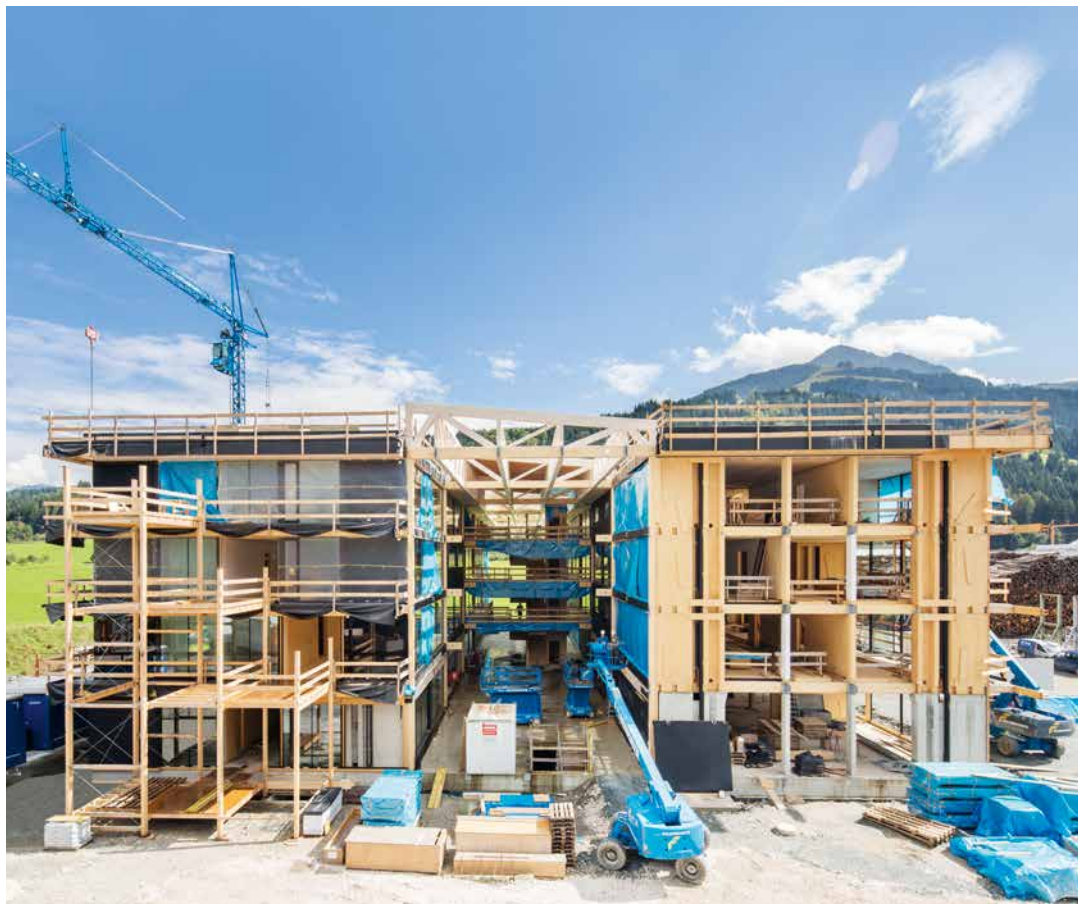
Le chantier du siège de St. Johann in Tirol (Autriche) : le bâtiment administratif fabriqué avec nos propres matériaux abrite plus de 250 postes de travail.
